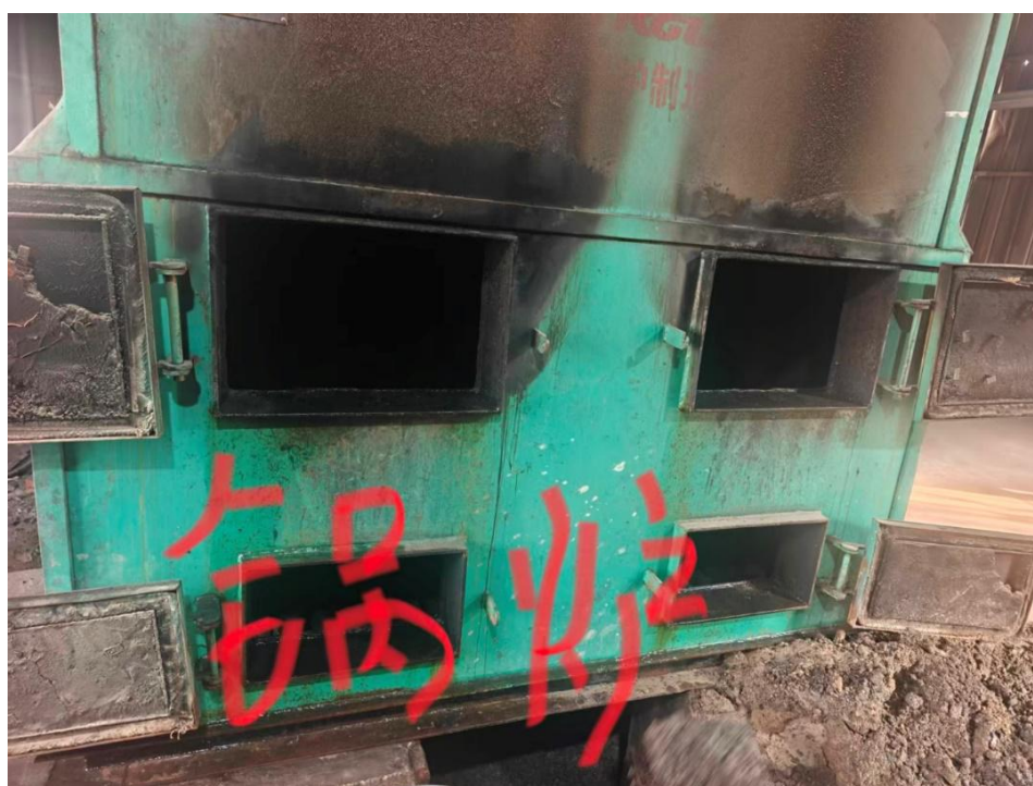
固镇县乐成肉鸡养殖有限公司锅炉
