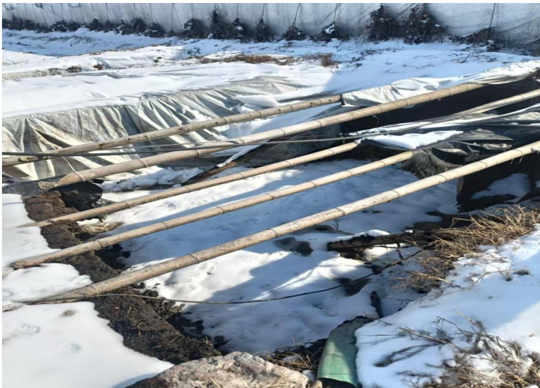
祥祥肉鸭养殖场破损化粪池
