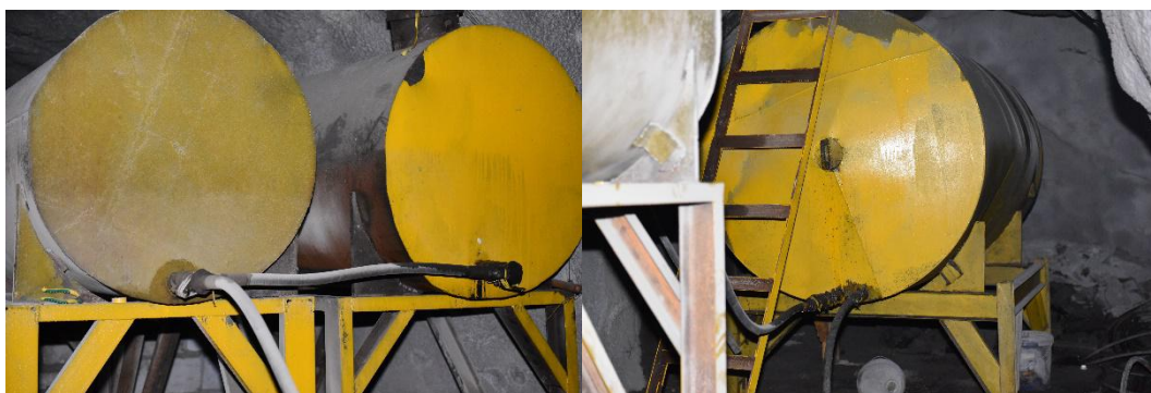
图 8 储油硐室内储油罐图
