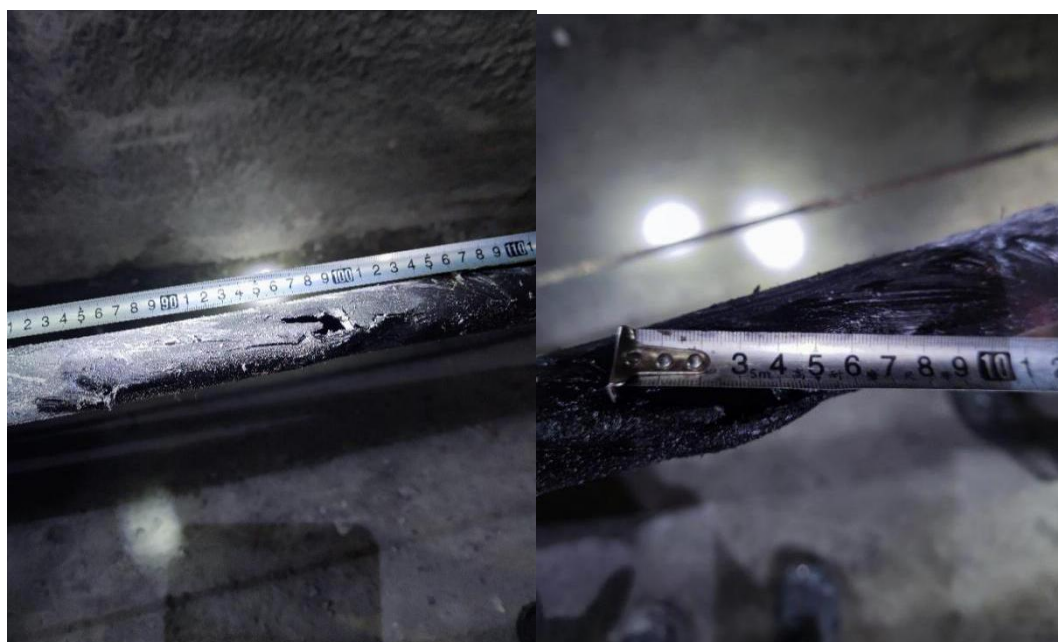
图 5 -440m 中段至-470m 联络巷输油管破裂图
